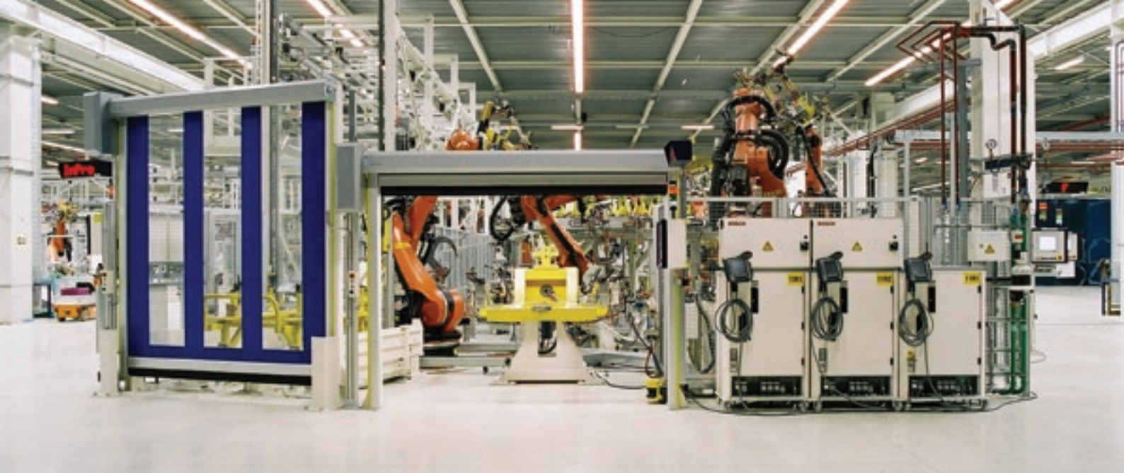
Esempio: porta in linea di assemblaggio
